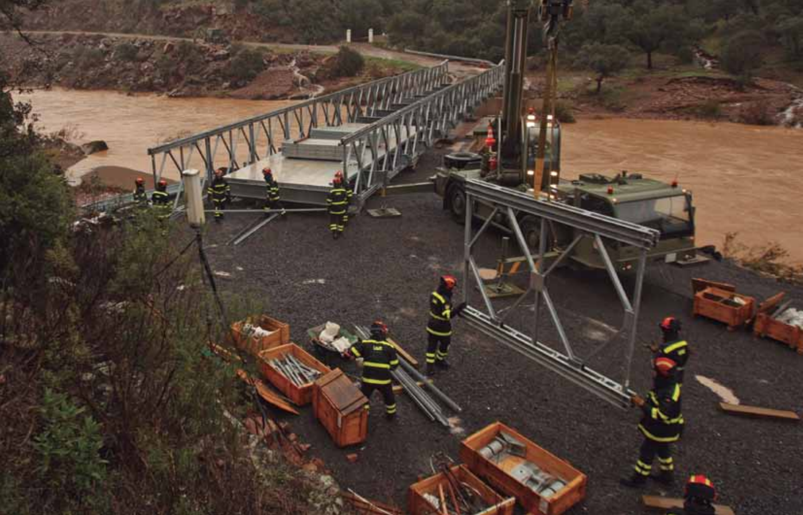
INSTALACIÓN DEL PUENTE MABEY EN MESTANZA, CIUDAD REAL. / BRIDGE INSTALLATION IN MESTANZA, CIUDAD REAL.
