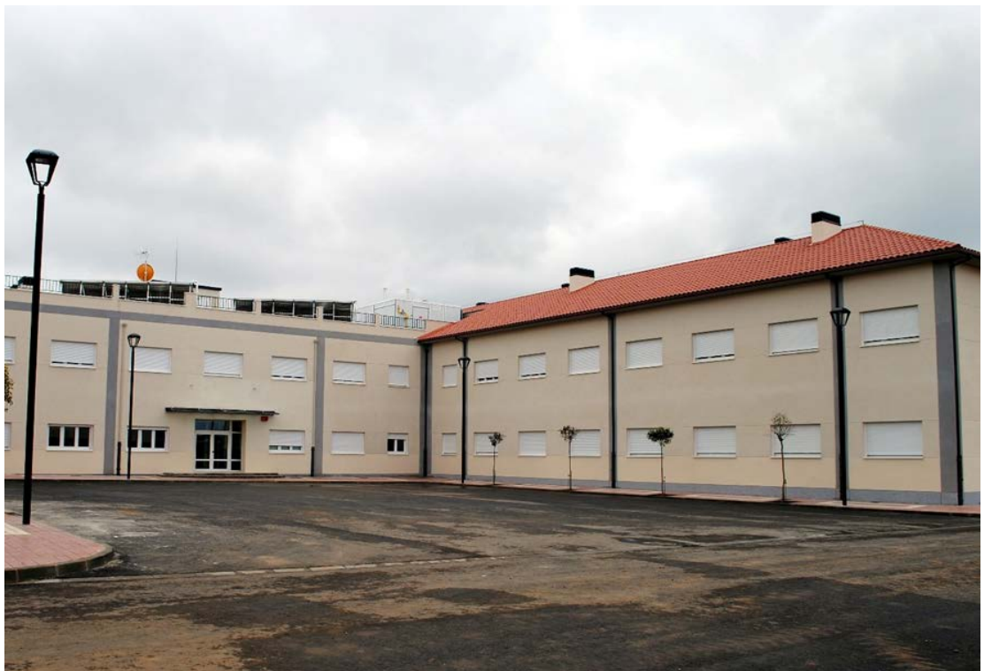
Construcción del edificio de alojamientos en la Academia Básica del Aire en León. Exteriores acabados
