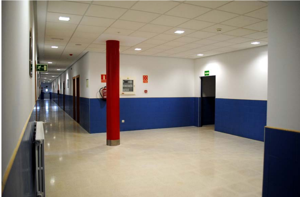
Construcción del edificio de alojamientos en la Academia Básica del Aire en León. Interiores acabados
