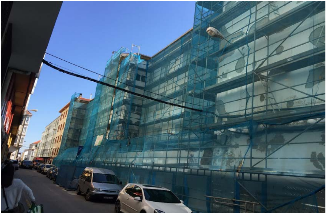
Reparación de fachada de edificio de viviendas militares en Ferrol, A Coruña.
