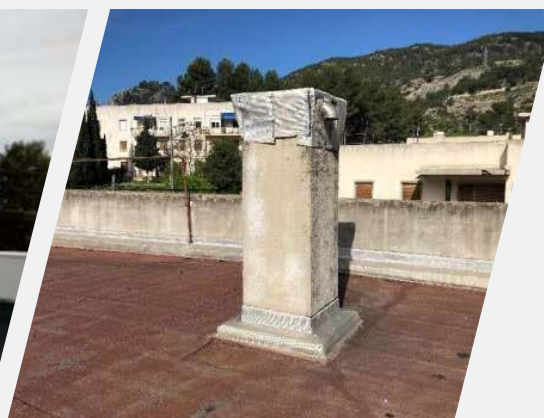
Obras de reparación de cubiertas en la Colonia de Aviación de Alcoy (Alicante)
