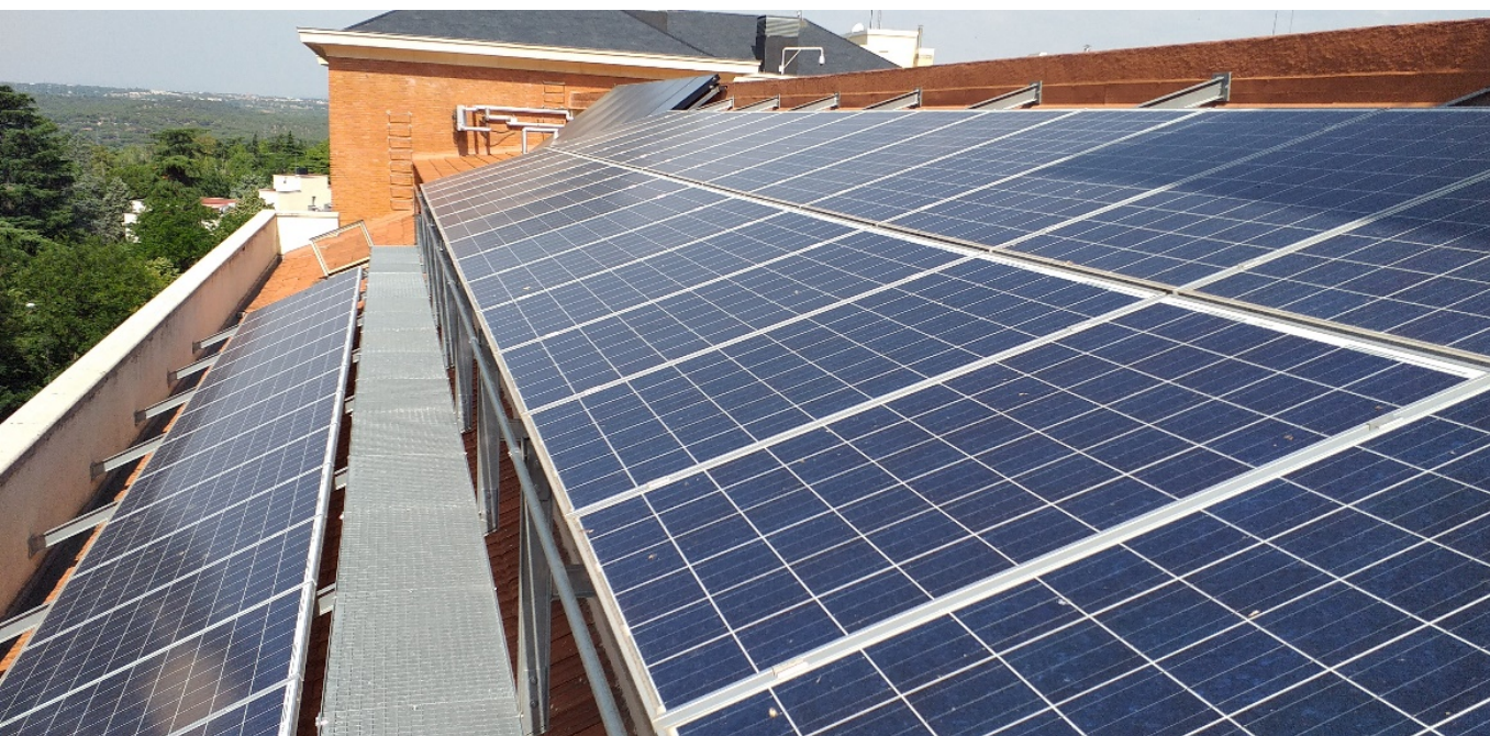
Placas solares instaladas en el edificio de la sede central del INVIED O.A.
