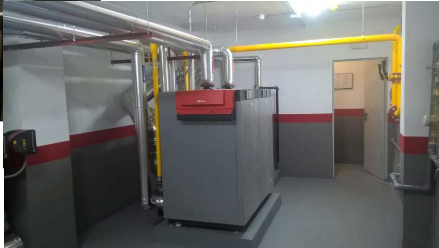
Obras de reforma y cambio a gas natural de la sala de calderas del inmueble sito en la calle Modesto Lafuente. Madrid
