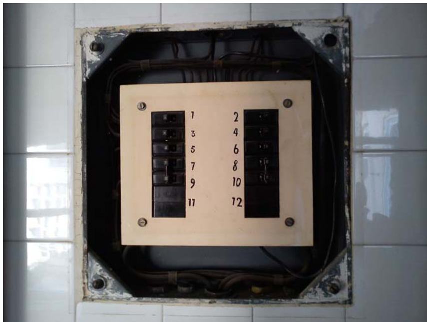
Cuadro eléctrico presente en las viviendas.
