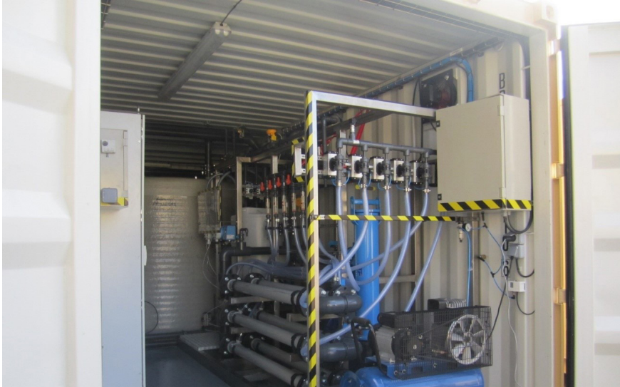
Figura 13. Planta depuradora sistema biológico BRM de membranas externas a presión. Fuente: https://www.protecmed.com/wp-content/uploads/2017/03/Ejercito-I.jpg
