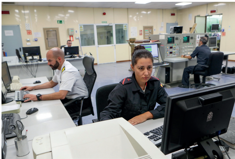
En el centro técnico de control de transmisores se supervisa el correcto funcionamiento de los equipos de emisión.
