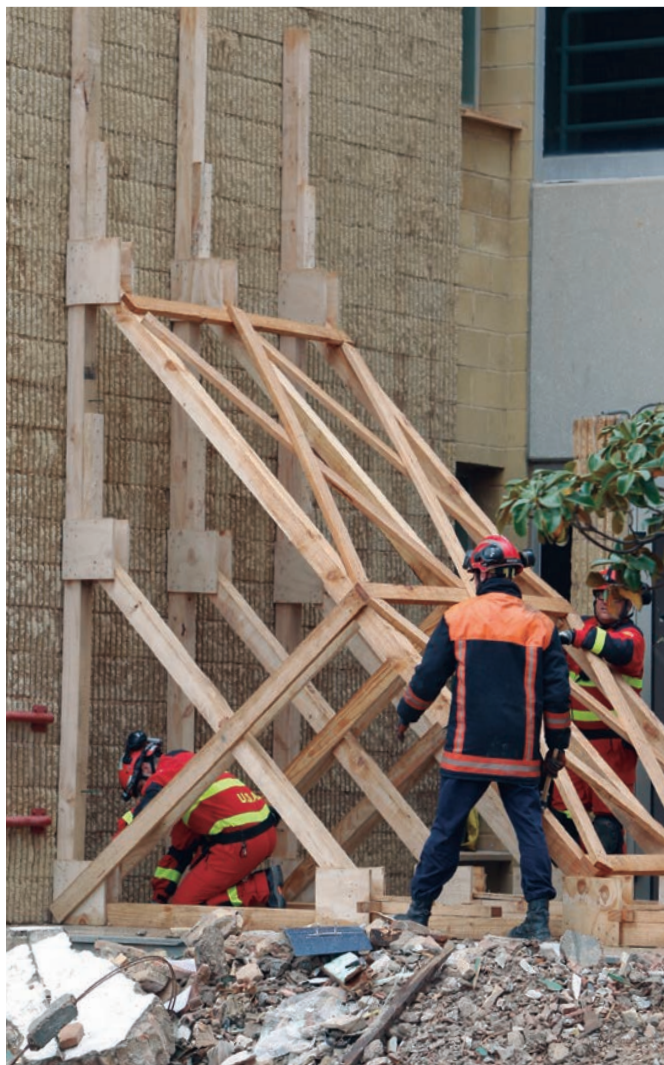
Miembros del equipo de búsqueda y rescate urbanos, junto a los bomberos, apuntan un edificio afectado por el terremoto.
