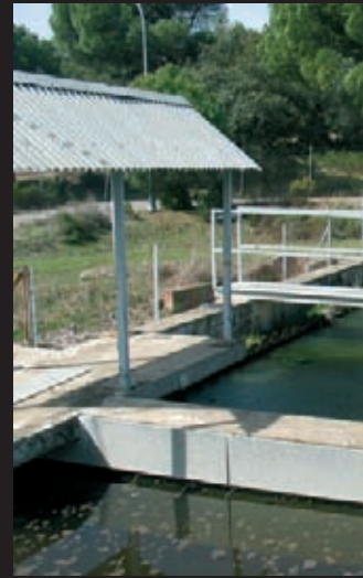
Depuradora de la base militar de Cerro Muriano de la Brigada Mecanizada Guzmán el Bueno X (Córdoba).
