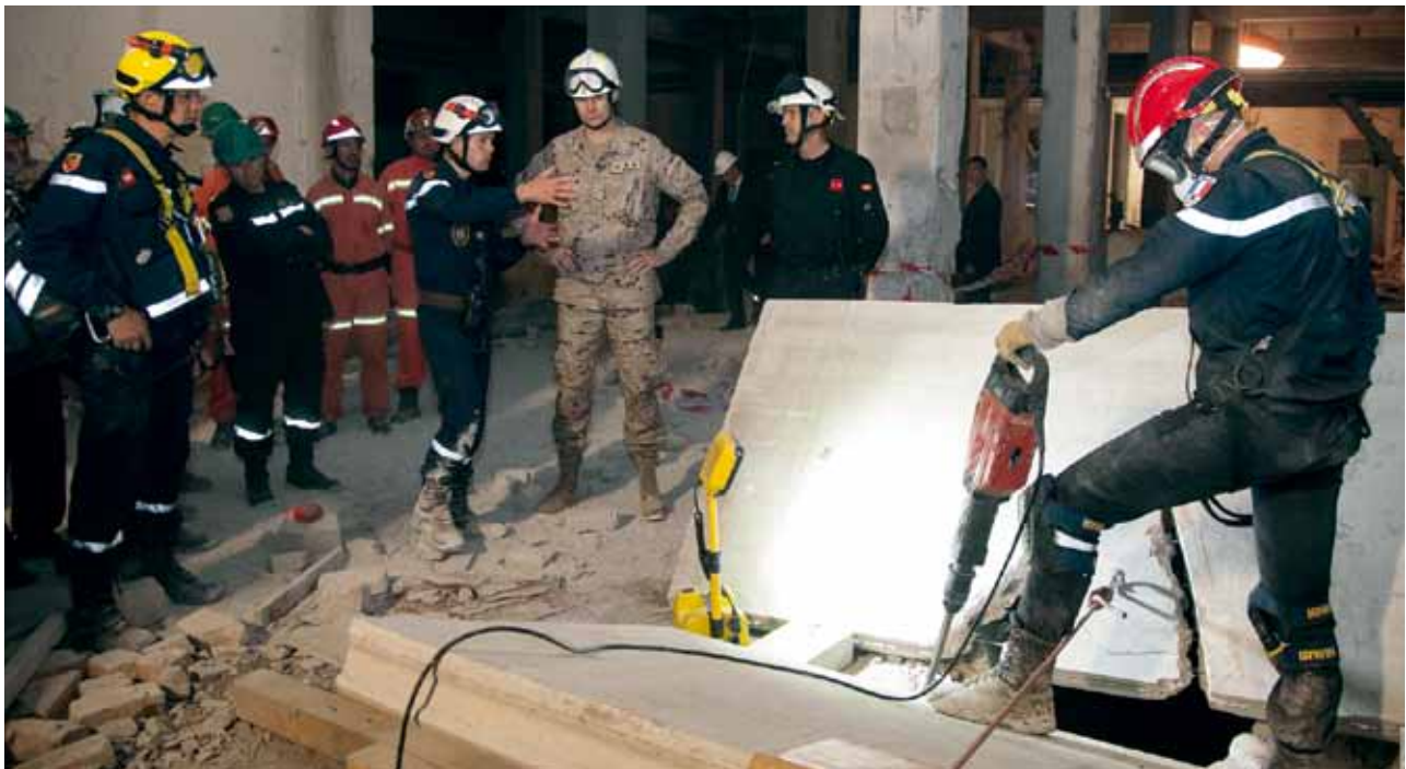
El Príncipe Felipe siguió los trabajos de apuntalamiento y rescate de víctimas provocadas por el derrumbe de edificios.
