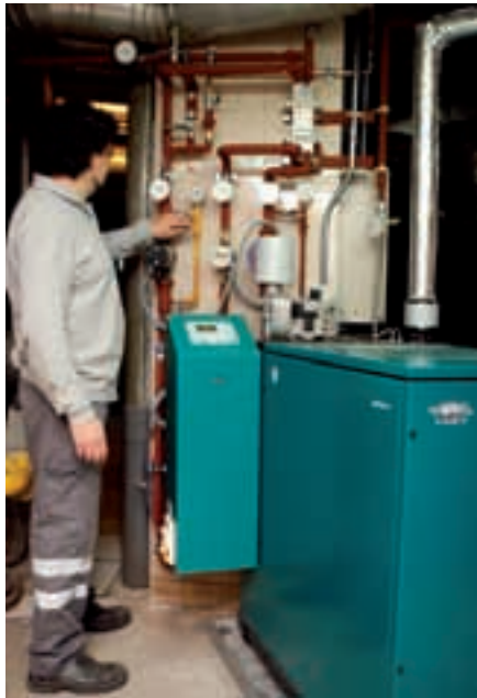
La instalación de microcogeneración del Ministerio produce tanto electricidad como calefacción y refrigeración.
