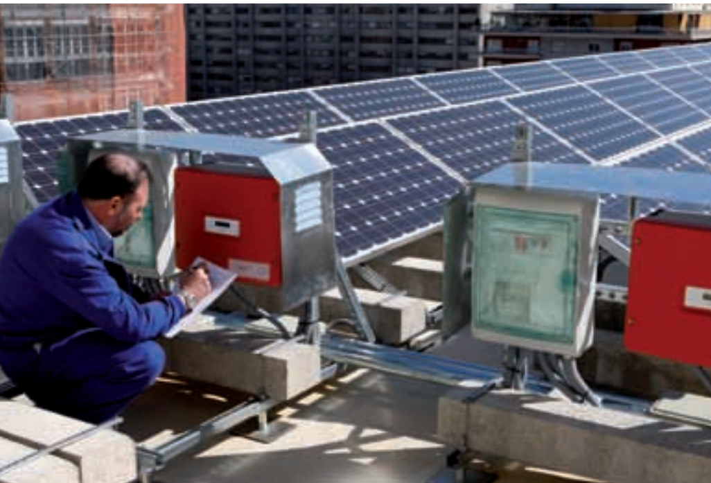
En la azotea del edificio del Órgano Central se han instalado paneles solares fotovoltaicos para la producción de energía eléctrica.
